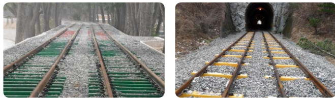
▲ 동해 레일바이크 시공사례
